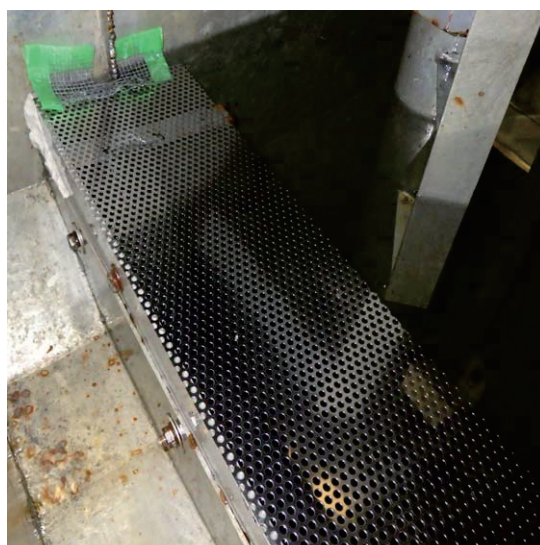
写真-3 浮遊物除去傾斜板
