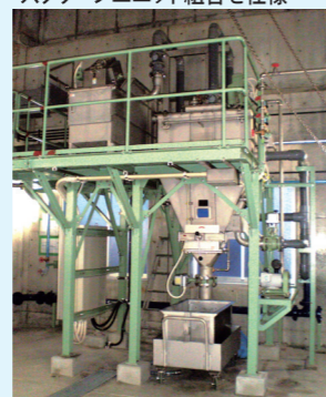
沈砂池の除塵機目中が大きく、装置側でし渣の除去も行う方式
