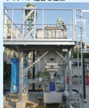
し渣を分離し、沈砂のみを装置に投入洗浄する方式
